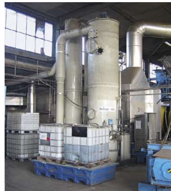
Ammoniakstrippanlage für die Herstellung von Ammoniumsulfatlösung (Brinamon). Das aus einem Fabrikationsprozess anfallende Ammonium wird im Luftstrom als Ammoniak ausgetrieben und im nachfolgenden Prozess ausgewaschen und an Säure gebunden.
